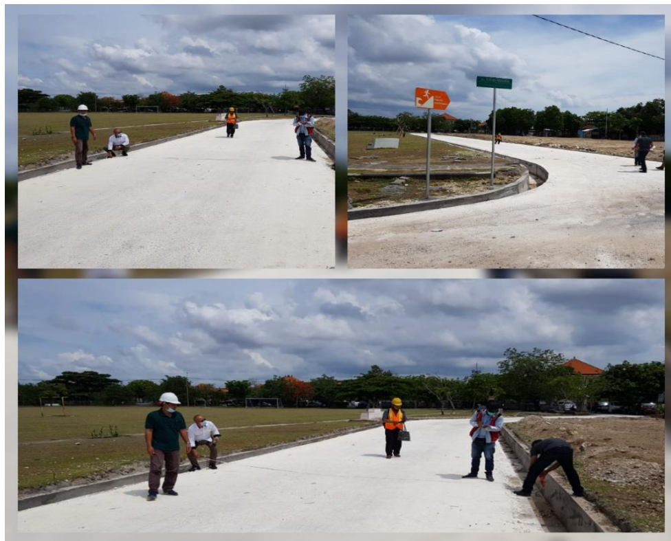
Gambar 3.9 Pembentukan Badan Jalan Menggunakan Limestone di Jalan Tukad Pekaseh Kelurahan Serangan di Kecamatan Denpasar Selatan
